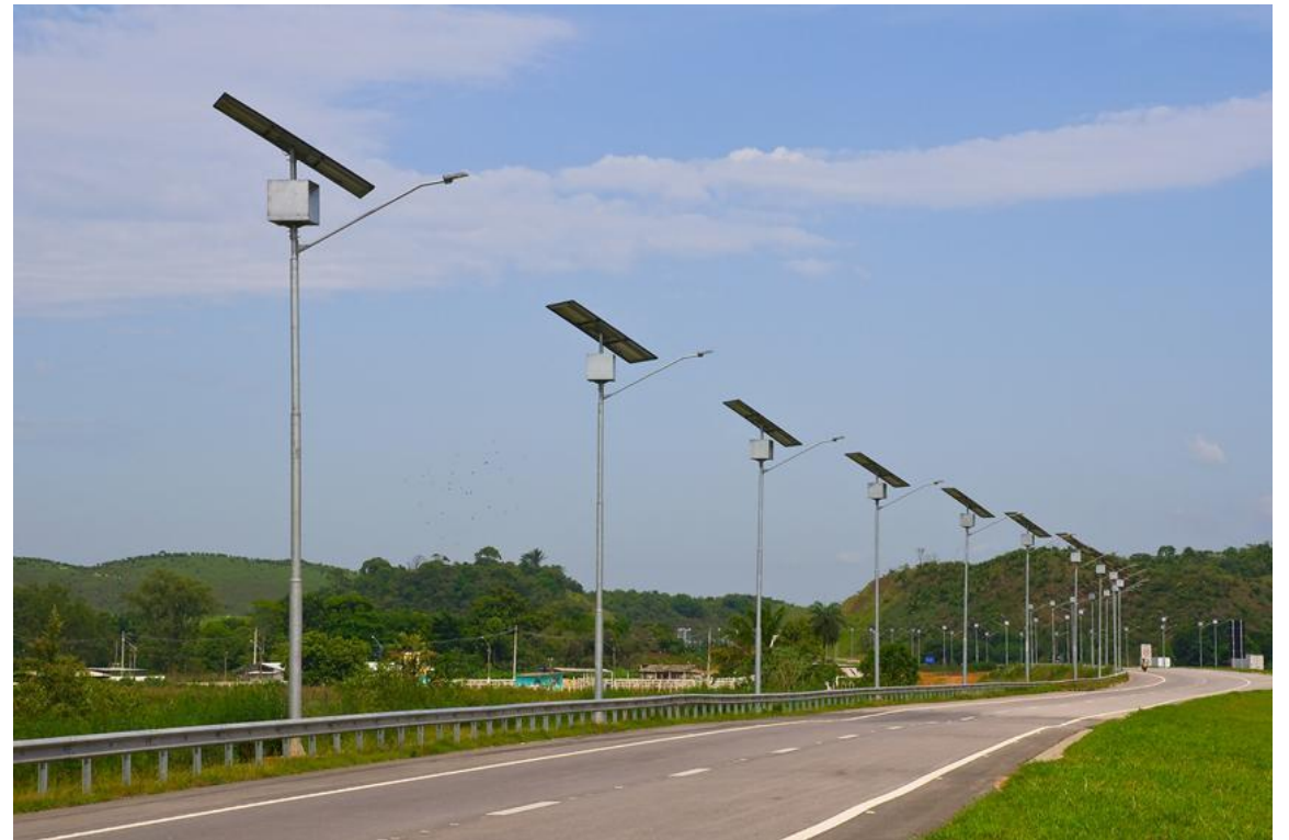
Iluminação Solar – Arco Metropolitano – Rio de Janeiro - RJ
